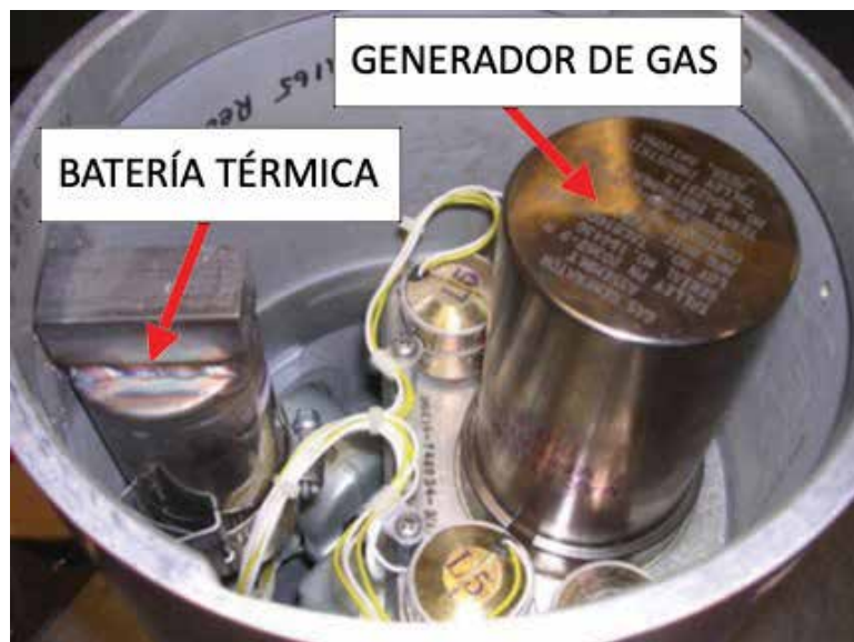
Figura N°8.14 Ubicación de la batería térmica y generador de gases en la CCG
